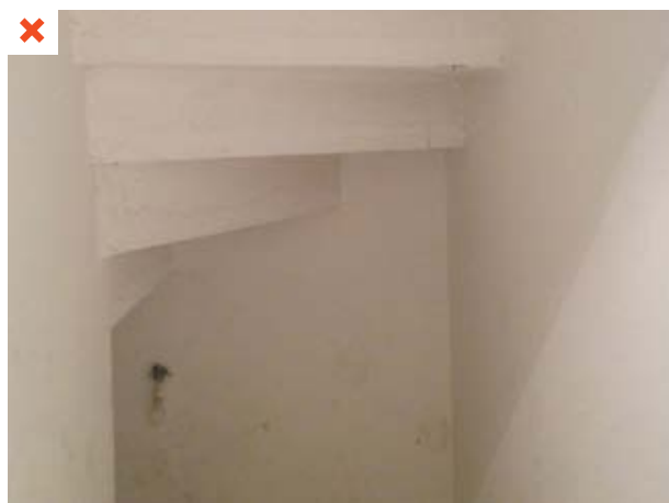
Cages d'escalier non isolées. ©AQC
